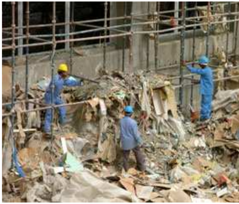
شکل ۱۳- عملیات عمرانی و مخاطرات آن
