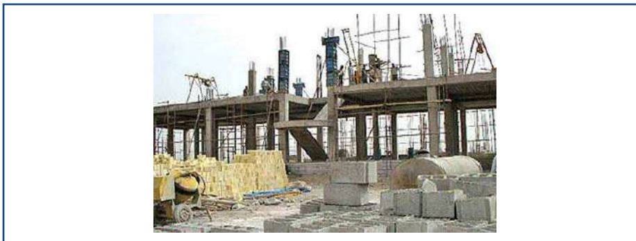
شکل ۲- عوامل زیان آور شیمیایی در ساختمان سازی
