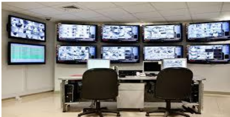
شکل ۱. نمونه اتاق مانیتورینگ از نظر چیدمان تجهیزات
